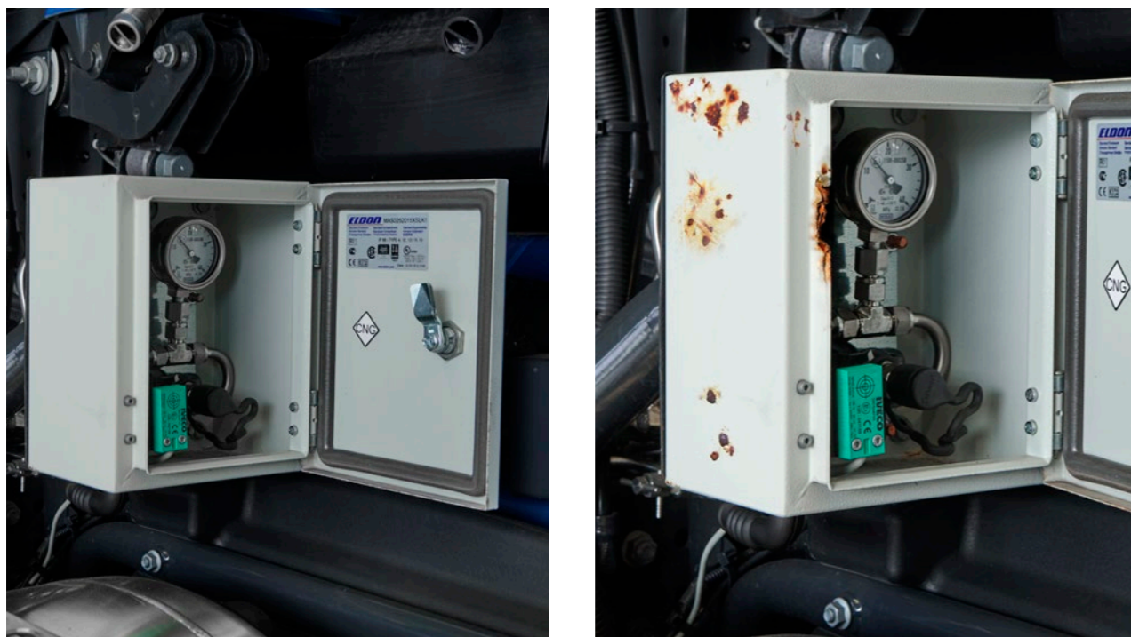
Hrdza na ochrannej nádobe plnenia CNG → záznam bez poplatku za poškodenie.
