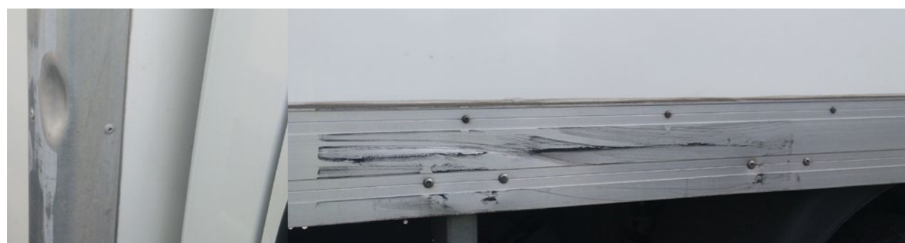
Bočné profily nadstavby: deformácie v rámci ekonomickej opravy
