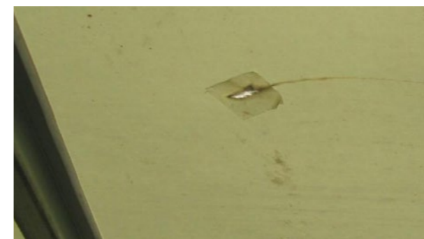
🔧 Střešní prostor: perforovaný nebo potrháný, v rámci ekonomičnosti opravy
