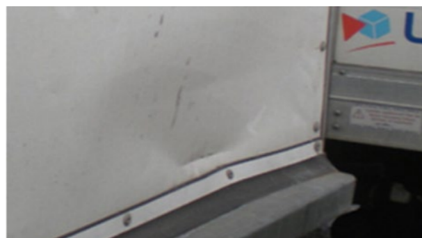
🔧 Boční a zadní dveře: výrazná deformace: doba opravy > 1 h v mezích odpovídajících ekonomičnosti opravy, uzavření, bez utěsnění
