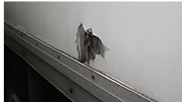
Dřevěné boční panely: poškozená dřevěná podpěra \geq 20 cm
